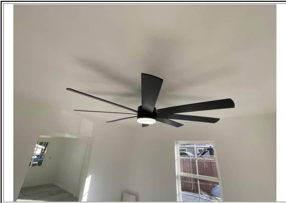
LIVING ROOM CEILING FAN
